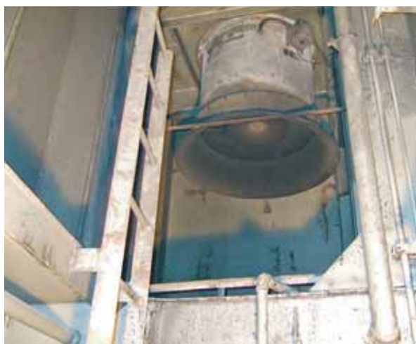
En af de gamle strømslugende ventilatorer, der nu er erstattet af energibesparende EC-ventilatorer.
