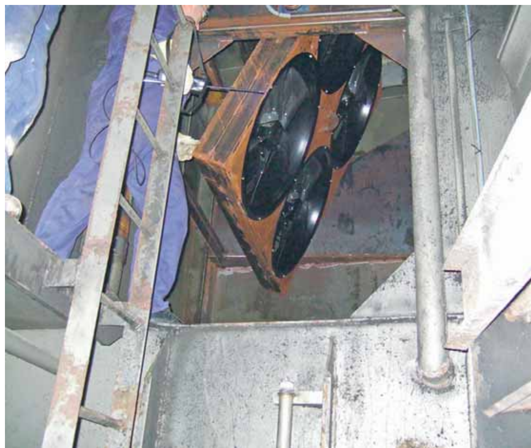
Fire ATEX EC-ventilatorer er monteret på en plade, der kan vippes en halv omgang, så de kan blæse i forskellige retninger på vogndækket afhængig af sejlretningen.
