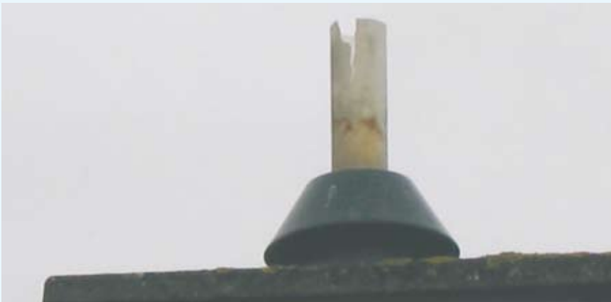
Aftræksrøret på dette billede er eksempel på installationer hvor "det hvide aftræksrør" smuldrer/forvitrer efter en årrække. (Foto: HNG)
